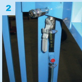
2 Andningsluft i korgen.
